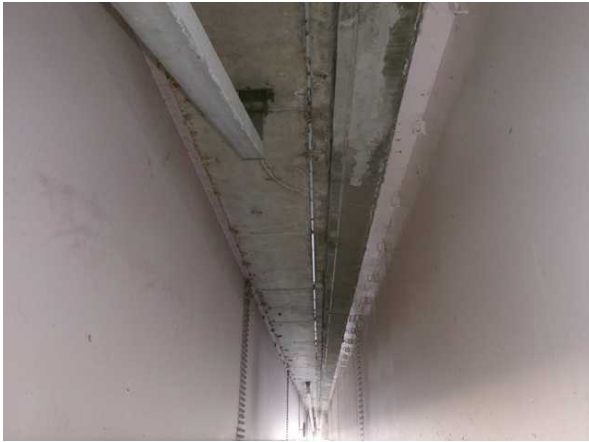
바닥관하면 S2 내측 캔틸레버 상태현황
