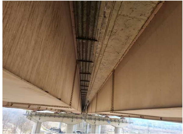
바닥관하면 S4 내측 캔틸레버 상태현황
